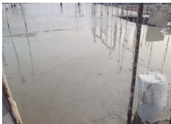
Figura 4. Exudación elevada en losa de concreto.
