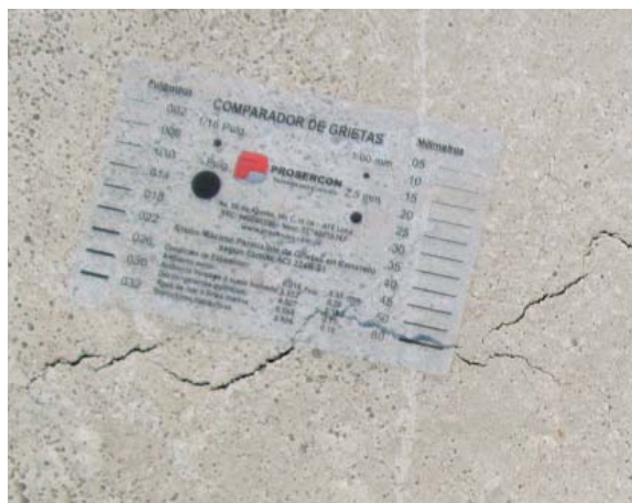
Figura 3. Fisuras por contracción plástica.
