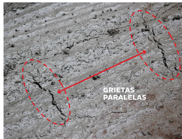
GRIETAS EN EL CONCRETO DEBIDO A LA CONTRACCIÓN POR SECADO FOTO N° 2
