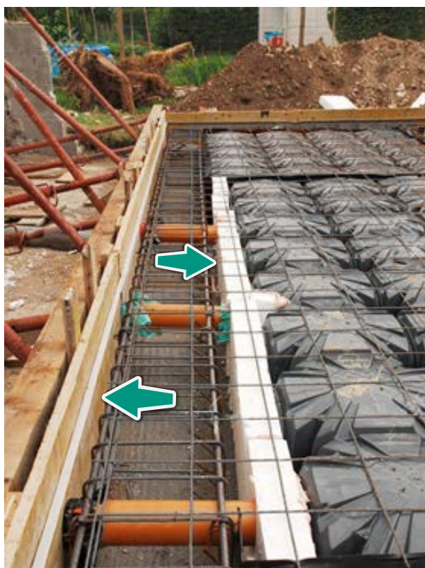
OBSERVE EL LADO INTERIOR DEL ENCOFRADO QUE ESTARÁ EN CONTACTO DIRECTO CON EL CONCRETO FRESCO
