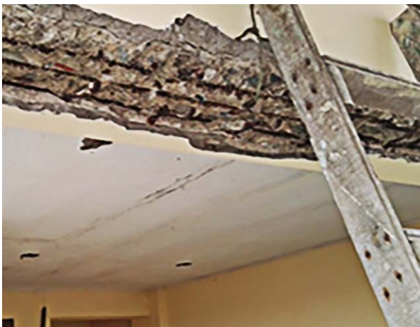
AGRIETAMIENTO Y DELAMINACIÓN DEL CONCRETO DEBIDO A LA CORROSIÓN DEL ACERO DISTRITO: VILLA EL SALVADOR
