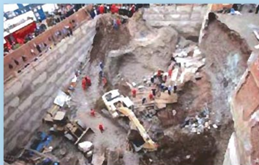
Calzadura colapsada - Caso La Victoria.
