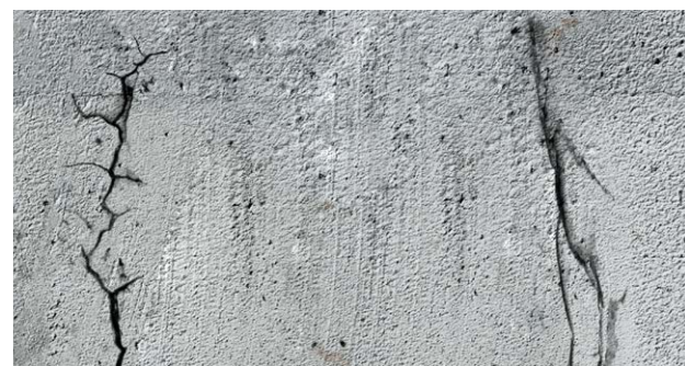
IMPERFECCIONES EN EL CONCRETO (GRIETAS)
