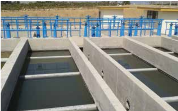
PLANTA DE TRATAMIENTO DE AGUA
